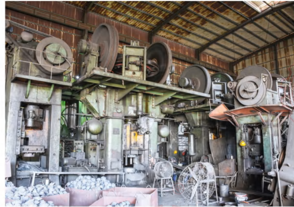
1600吨锻造线 Forging Line
